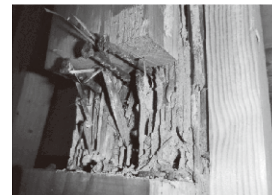
④腐朽の被害例(上)、シロアリ被害例(下)
